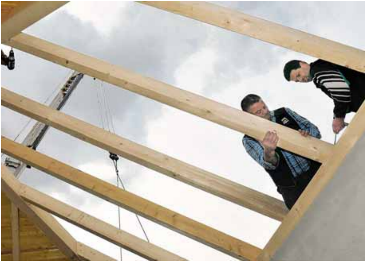
Sternenhimmel aus Holz: Klaus Leichtle und Christian Weiß (von links) bauen den Dachstuhl auf. Mit einem Durchmesser von fünf Metern wird dann mit Gips eine Halbkugel in die Decke gebaut. Sie stellt den künftigen Sternenhimmel dar.
